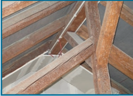
Schimmelpilzbefall im Dachstuhl
